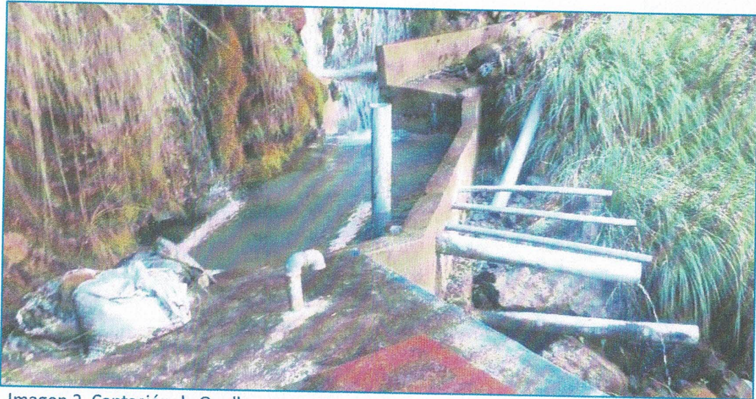
Imagen 2. Captación de Quelloyacu
