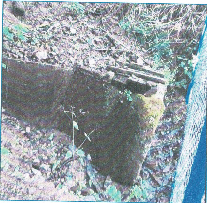
Imagen 3. Captación de Negrohuaycco
