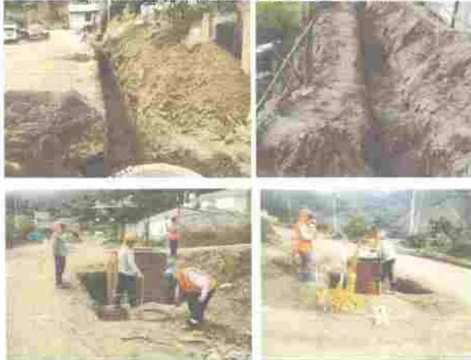
Imágenes n.° 22 y 23 Excozación no cuenta con pasos peatonales sobre zanjas y acólitos correspondiente
