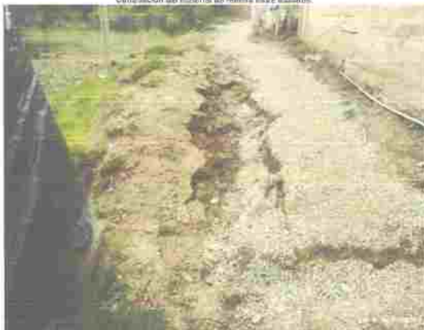
Imagen n.º 3 Contracción del material de relleno entre buzones.
