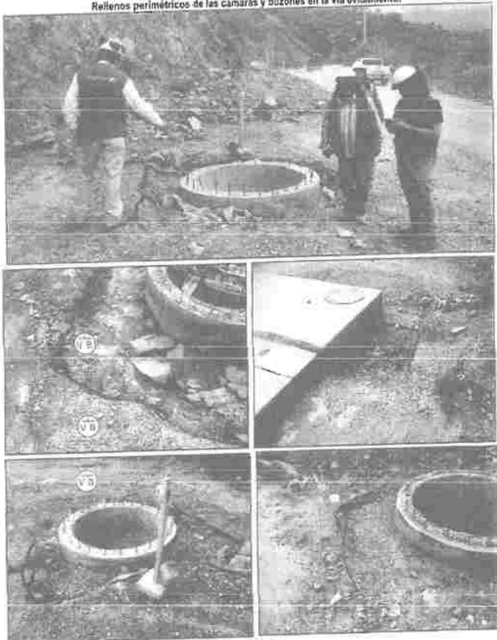
Imágenes n.º 7, 8, 9, 10 y 11 Rehenos perimétricos de las cámaras y buzones en la vía evitamiento.
