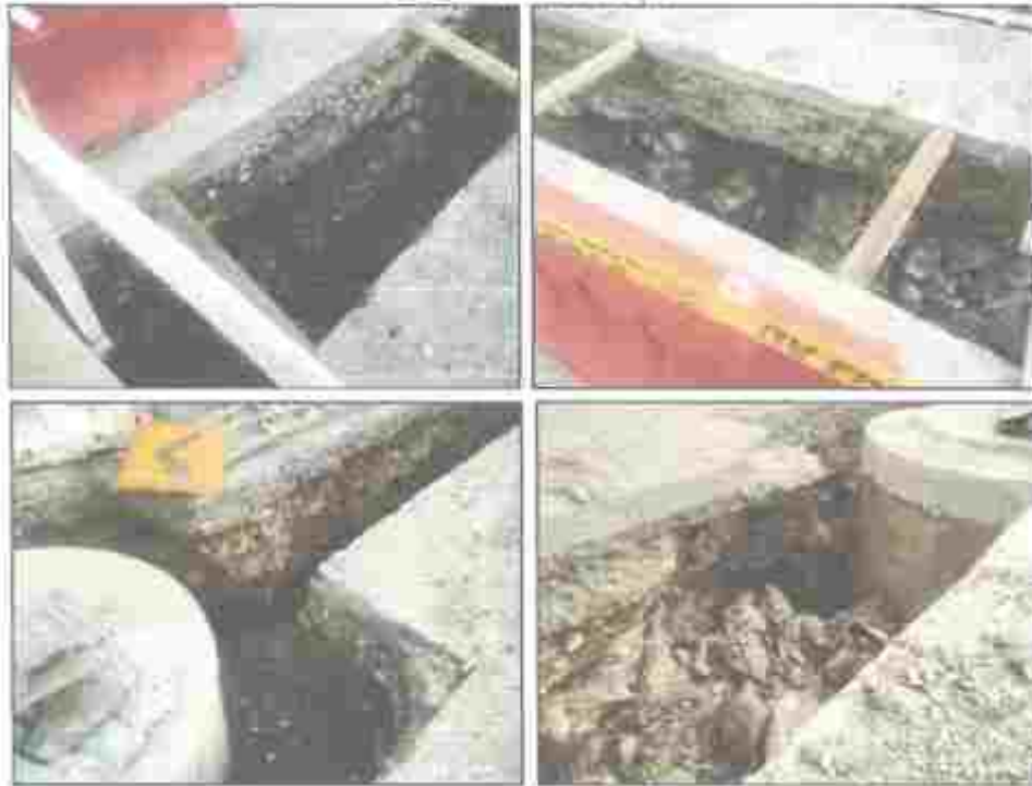
Imágenes n.º 16, 17, 18 y 19 Cavidades en muros de zanja.
